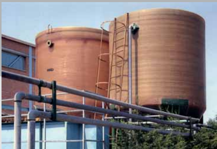
Sedimentatore-Decantatore per liquami, capacità 25 m 3 . Sedimentator-decanter used for sewage, capacity 25 m 3 . Absetzbecken-Dekanter, für Schmutzwasser, Kapazität 25 m 3 .
